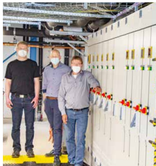
Projektleiter Stefan Rickens (rechts) mit dem Wissenschaftlichen Leiter der Versuchseinrichtung Wilfried Holzke und dem Technischen Leiter der Einrichtung Johannes Adler (Mitte) an der Hauptverteilung.
