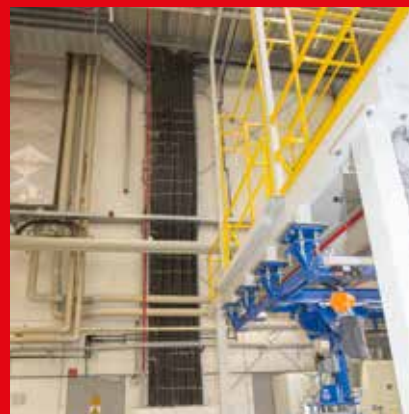
Alle Unternehmensbereiche sind bei Actega tätig: Die Harald Meyer Brandschutz-Elektro hat unter anderem die Starkstromanlagen installiert, die die Extruder mit ausreichend Energie versorgen.
